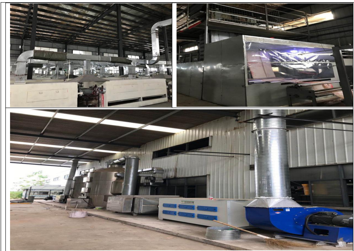
废气环保措施落实状况图
