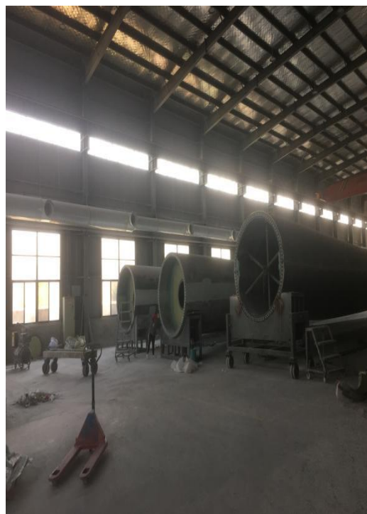
涂漆区上方分散设置废气收集口 (2#厂房东侧)
