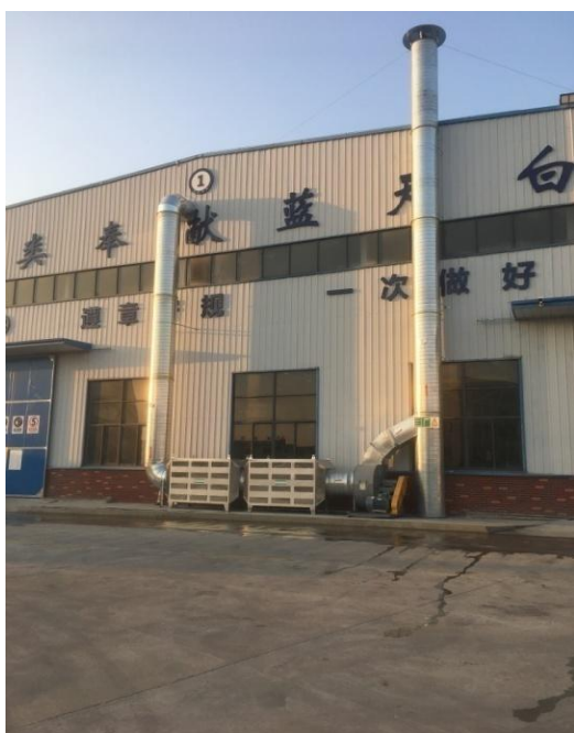
DA001 废气处理设施（位于 1#厂房南侧） 污染物：VOC 治理措施：两级活性炭吸附
