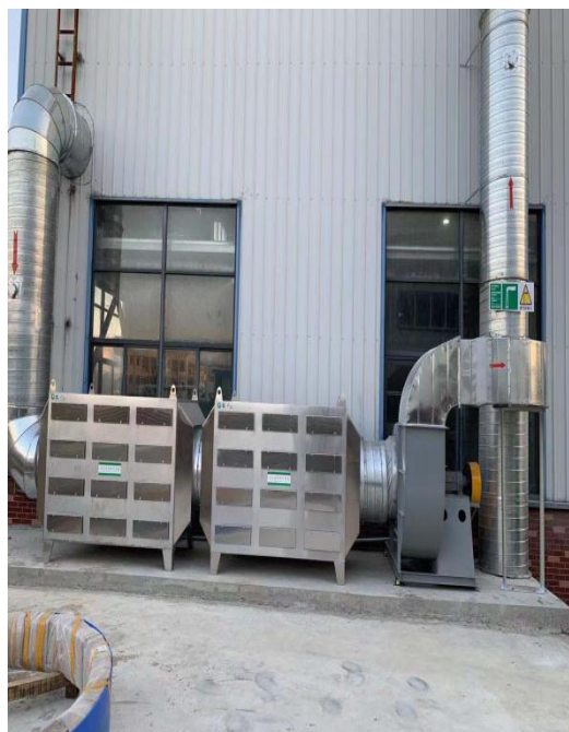
DA004 废气处理装置（位于 2#厂房北侧） 污染物：VOC 治理措施：两级活性炭吸附
