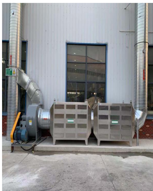
DA002 废气处理设施（位于 1#厂房南侧） 污染物：VOC 治理措施：两级活性炭吸附
