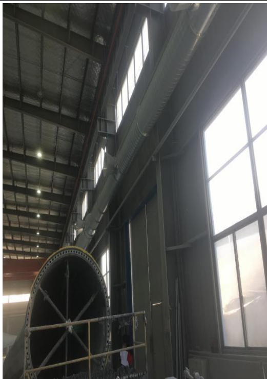
打磨区上方分散设置废气收集口 (2#厂房西侧)
