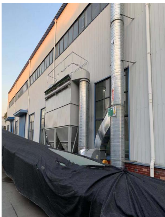
DA003 废气处理装置（位于 2#厂房西侧） 污染物：粉尘 治理措施：布袋除尘器
