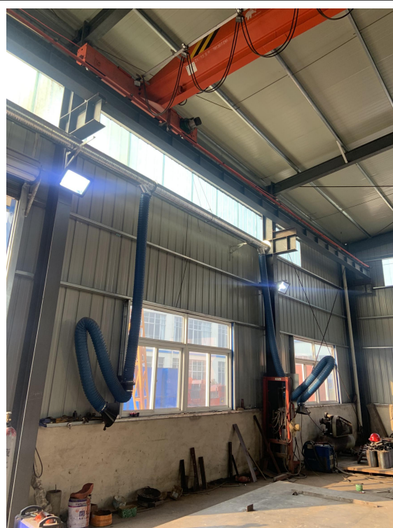
焊接和切割工序废气收集
