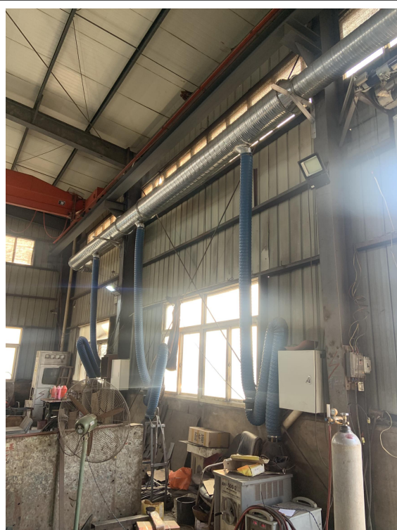
焊接和切割工序废气收集
