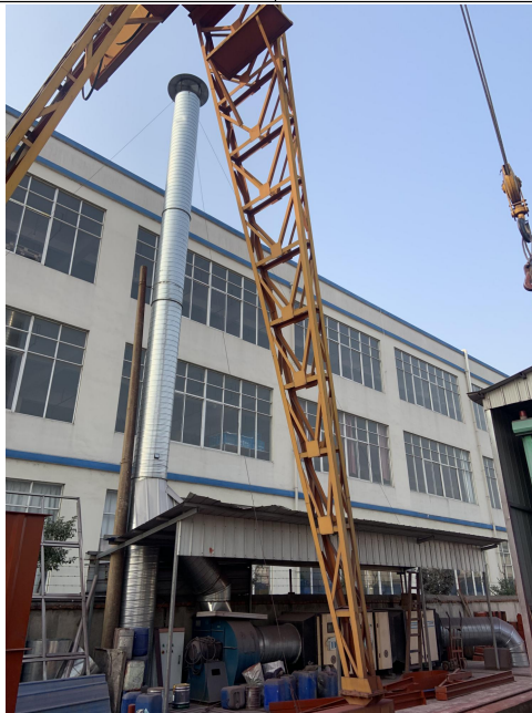
过滤棉+两级活性炭吸附装置+15m 高排气筒
