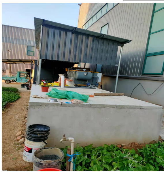
生产废水处理系统
