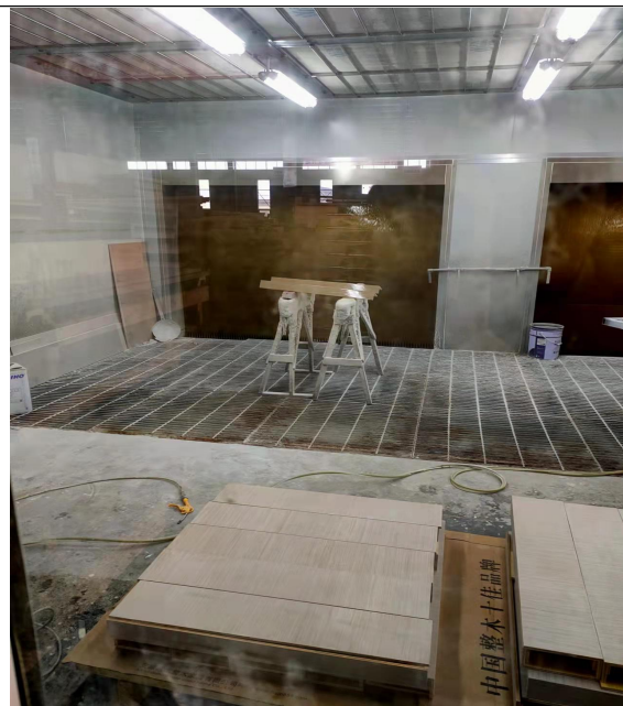
水旋涂装操作间（内）
