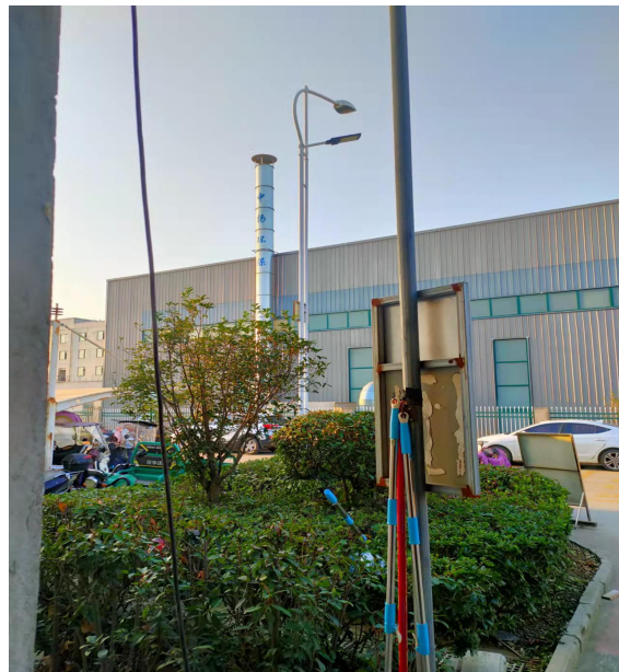
喷漆、烘干工序 15m 排气筒
