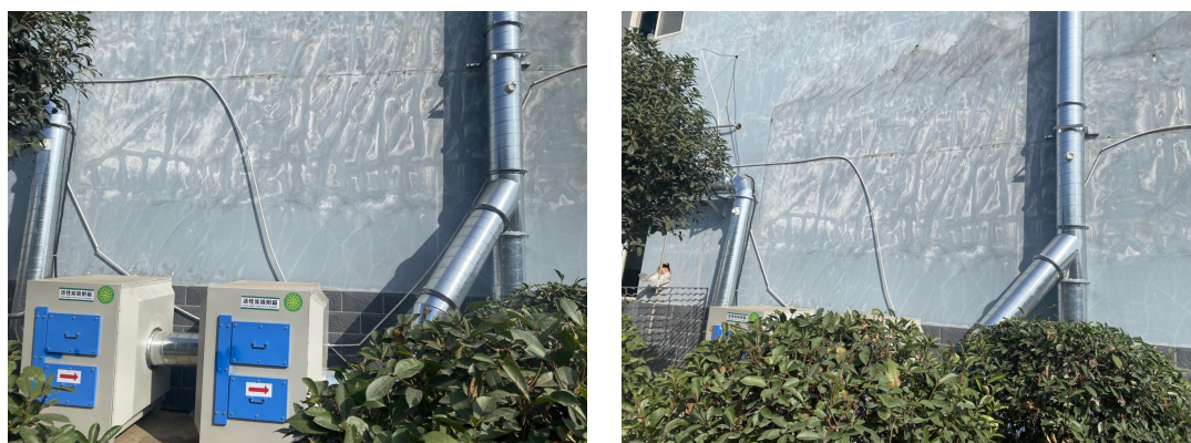
废气处理装置
