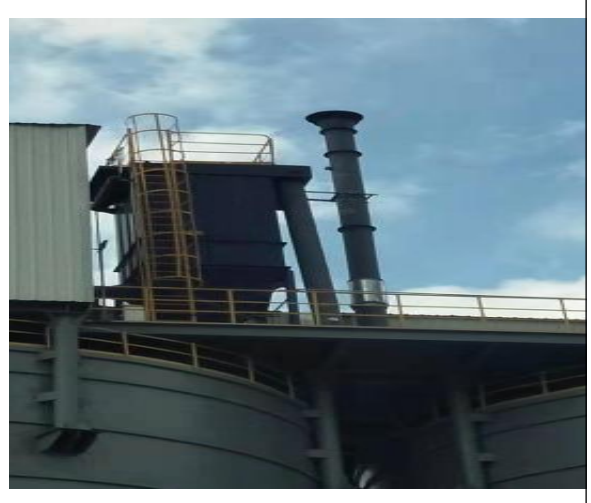
2#钢板库顶废气处理：高效袋式除尘器+35m 高排气筒
