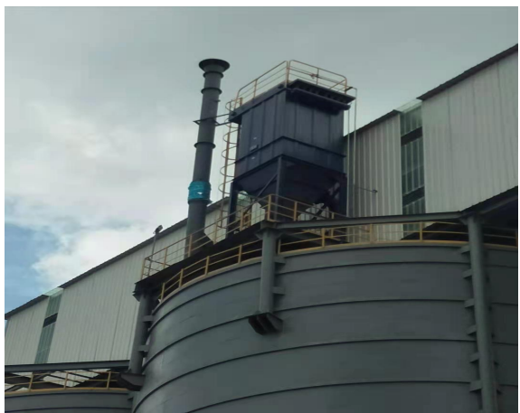
3#钢板库顶收废气处理：高效袋式除尘器+35m 高排气筒
