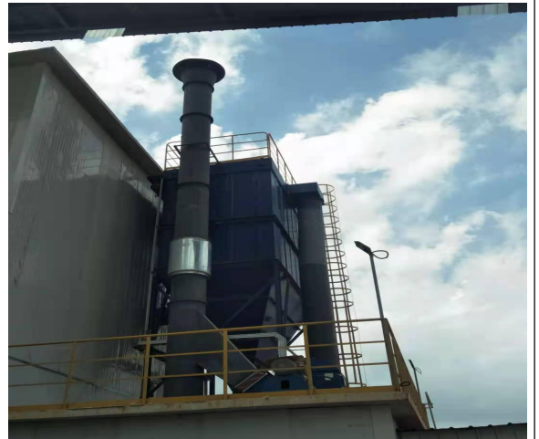
骨料二级破 2 收尘废气处理：高效袋式除尘器
