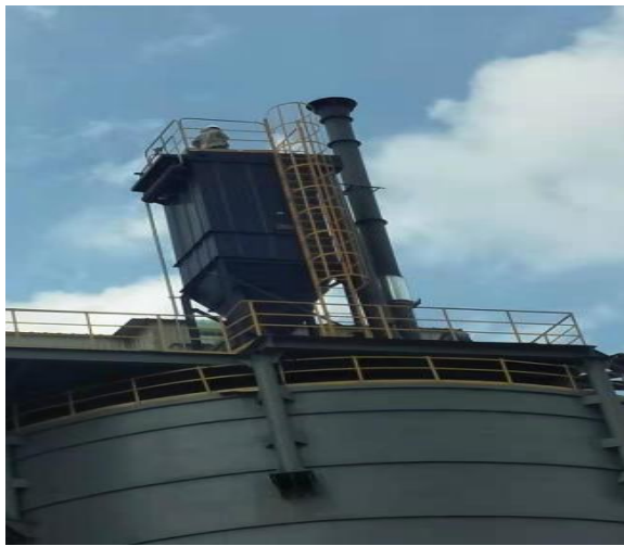
1#钢板库顶收尘废气处理：高效袋式除尘器+35m 高排气筒
