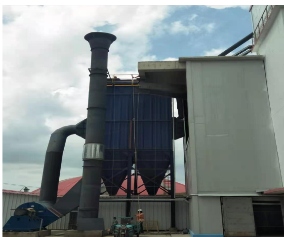
骨料二级破 1 收尘废气处理：高效袋式除尘器
